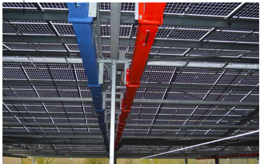
Foto 3: De rode railkokers zijn voor DC, de blauwe voor AC. Via een aftakkest op de rail, kan een laadpaal worden aangesloten.
