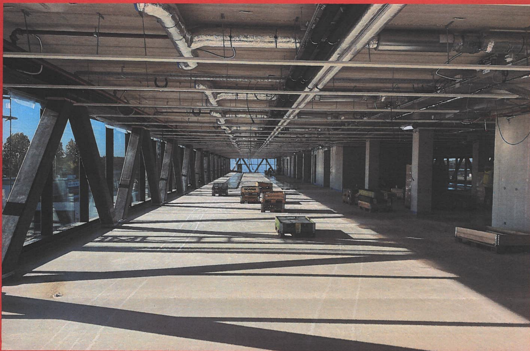
Een belangrijke rol bij het realiseren van een gezond binnenklimaat is weggelegd voor de klimaatplafonds van Verwol.
